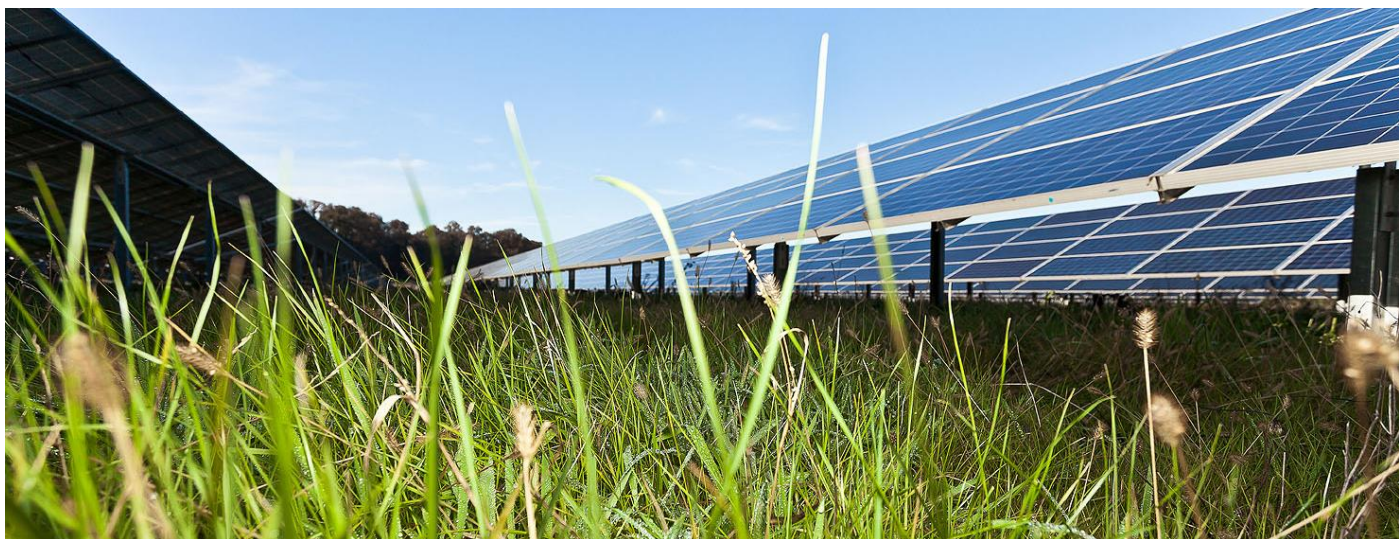
Figure 7 : Centrale solaire à panneaux fixes, Condom, Valeco
