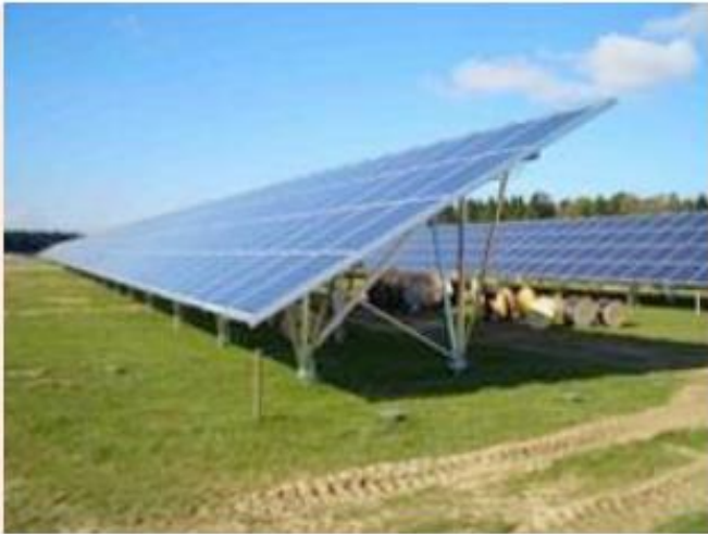
Figure 10 : Centrale de Pöcking, Allemagne
