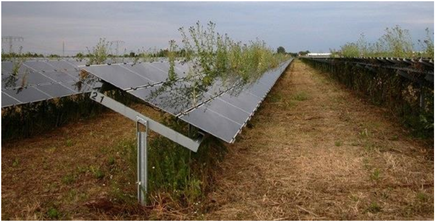
Figure 5 : Centrale photovoltaïque Markranstädt, Allemagne, entretenue mécaniquement entre les rangées, la végétation faisant de l'ombre sur les panneaux et présentant un risque incendie
