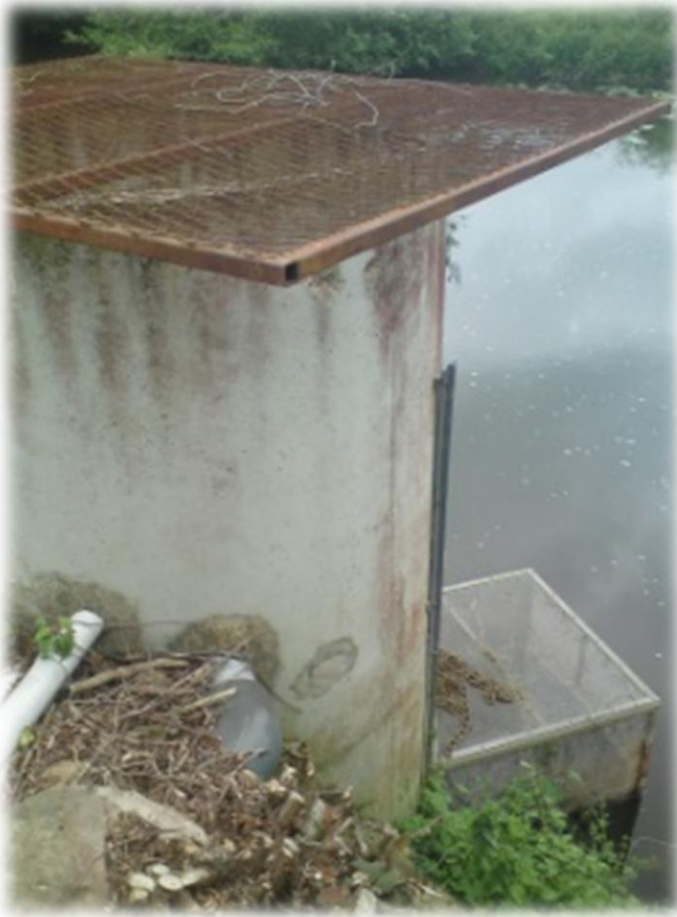
Illustration 27 : Buse en béton contenant les pompes
