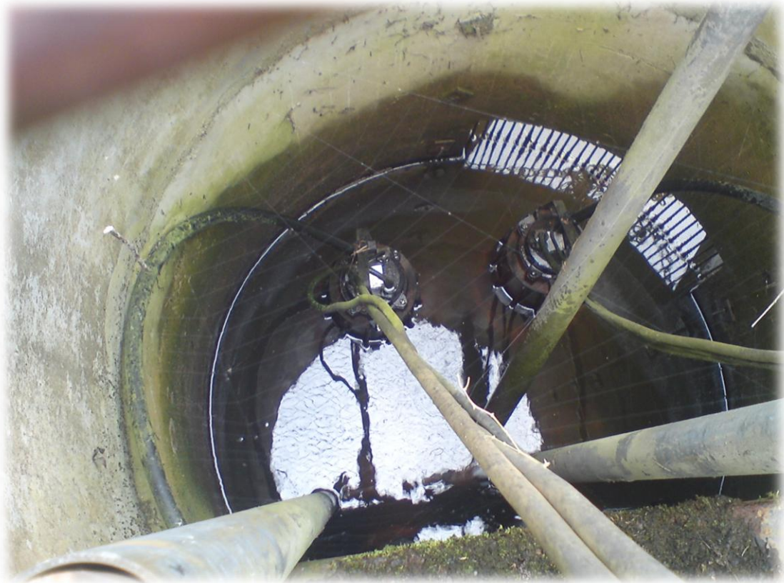
Illustration 28 : Vue plongeante sur les pompes immergées
