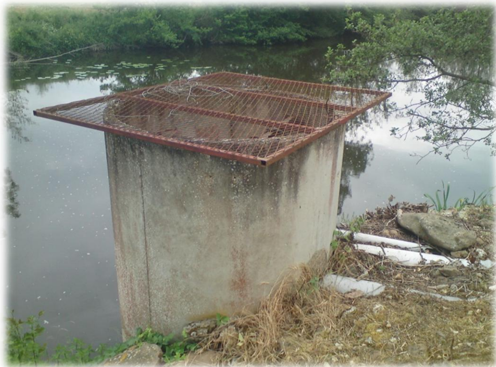
Illustration 18 : Point de pompage de la station
