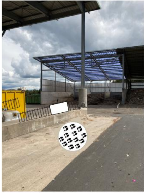
Panneau explicatif sur le socle en béton (attention qu'il ne dépasse pas) + zone d'arrêt (traces de pieds) + rambardes de sécurité
